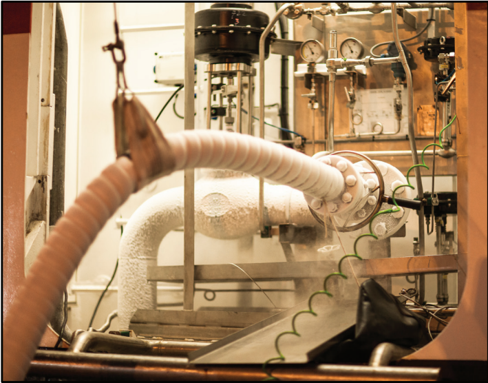
3" LNG Bunker Line
